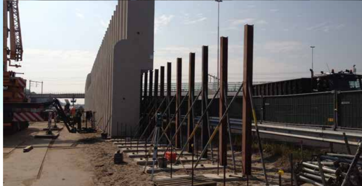
Links het 3D ontwerp van de architect van de tunnel bij Leidsche Rijn met de geluidsschermen, rechts de uitvoering van de schermen.
